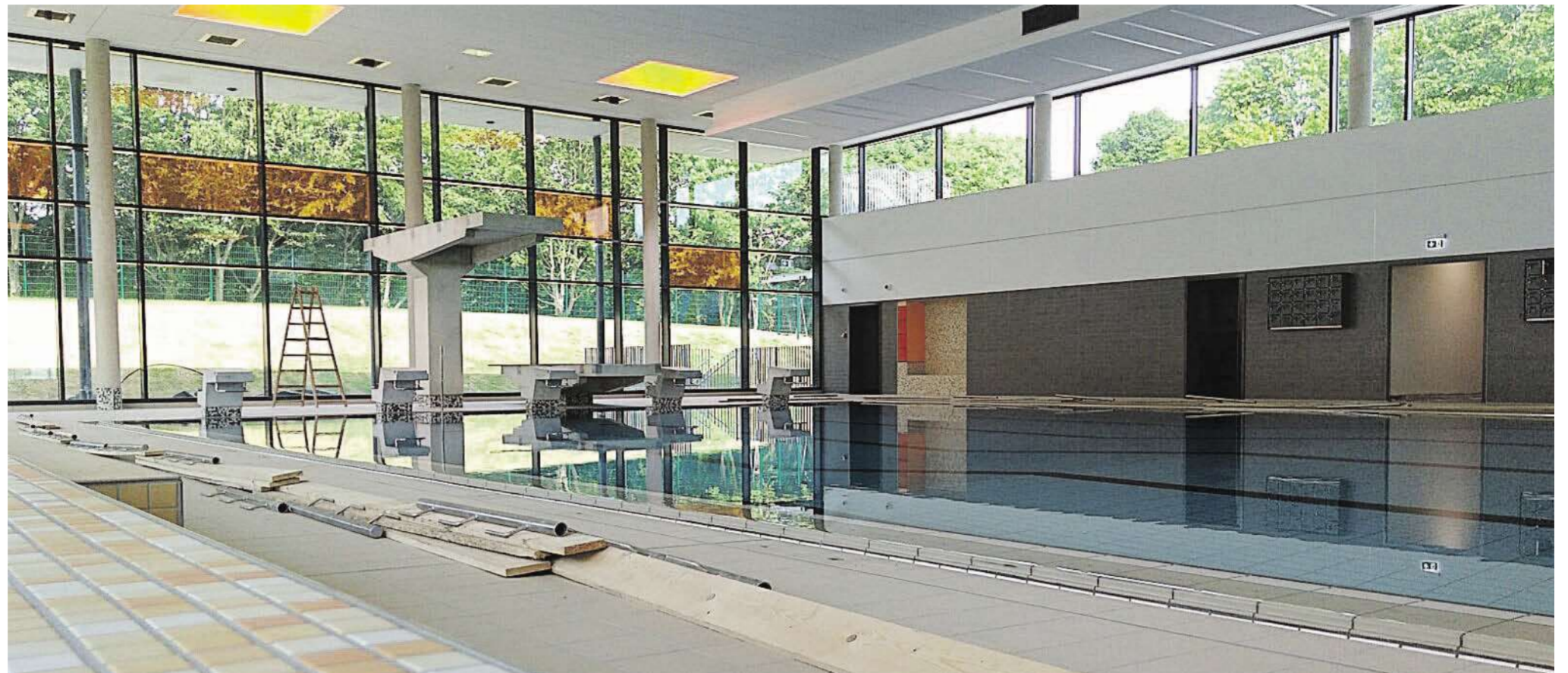
Herzstück des Hallenbades ist das Sportbecken mit fünf Bahnen, Startblöcken und Dreimeterturm.
