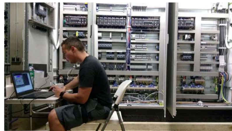
Ein Hallenbad besteht nicht nur aus Wasser, sondern auch aus jeder Menge Technik. Hier bereitet ein Programmierer die Steuerzentrale vor.
