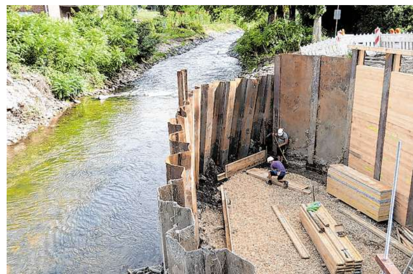
Derzeit werden die Fundamente für die neue Wurmbrücke bei Burg Trips gelegt. Die neue Brücke soll Ende Oktober aufgesetzt werden.
