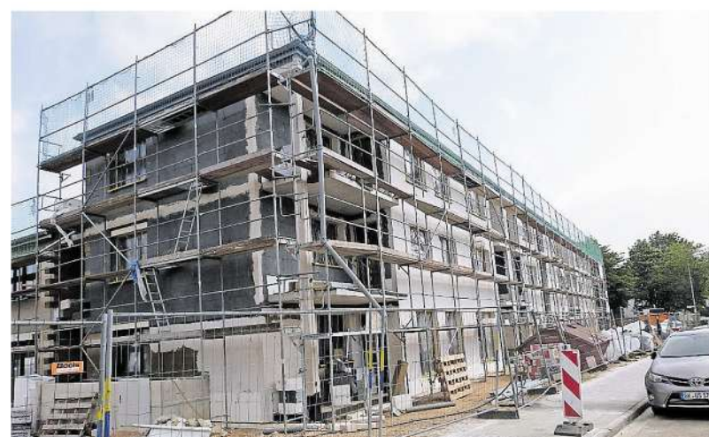
Die Arbeiten am zweiten Bauabschnitt laufen auf Hochtouren: Ende des Jahres soll der Bau fertig sein.
